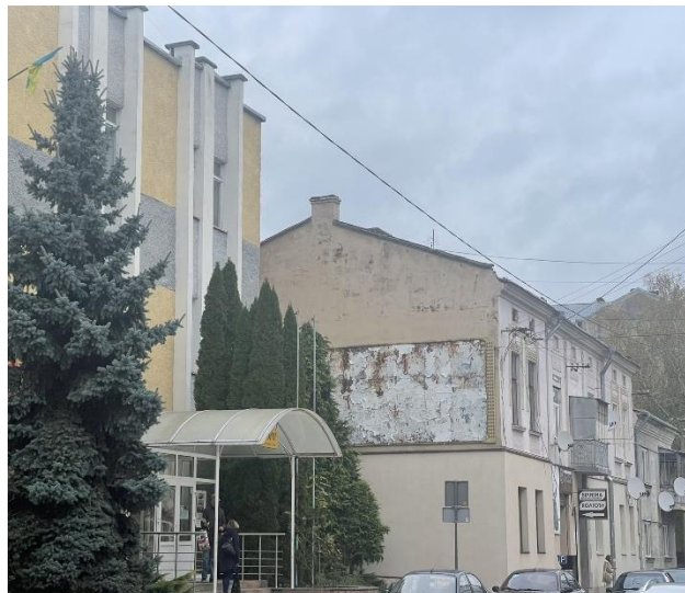
На фасаді буд.№7 вул.Поштова.
